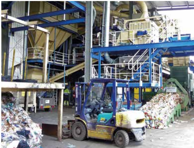
Afvalscheidingsinstallatie Attero Groningen
